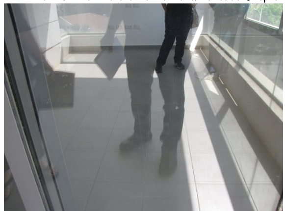
10.1. סדק בזכוכית ויטרינת מטבח. נדרש : החלפה.
