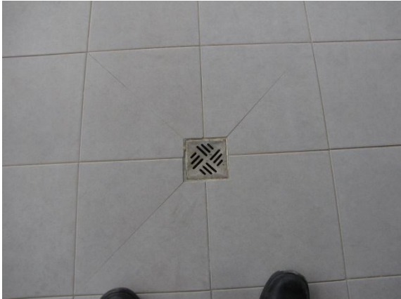
2.2 ל.א הותקן קולט מי גשם דו מפלסי במרפסת מרוצפת (נספח-1) זאת בניגוד לתקן ישראלי 1752 חלק 1 נדרש : ביצוע שיפועים איטום וקולט מי גשם דו מפלסי במרפסת מרוצפת בהתאם לתקנים.
