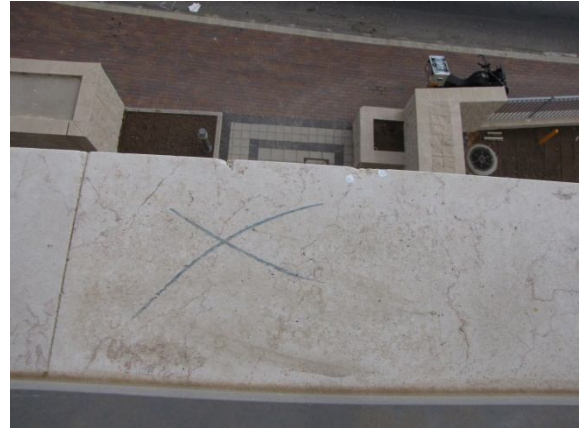
11.1. שיש בתחתית חלון סומן ע"י הקבלן לתיקון/החלפה ולא תוקן או הוחלף. נדרש : תיקון או החלפת השיש.
