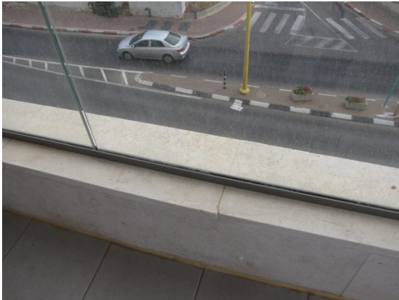
11.4. פינת קופינג שיש שבור מתחת למעקה. נדרש : תיקון וליטוש, או החלפת אריח קופינג.
