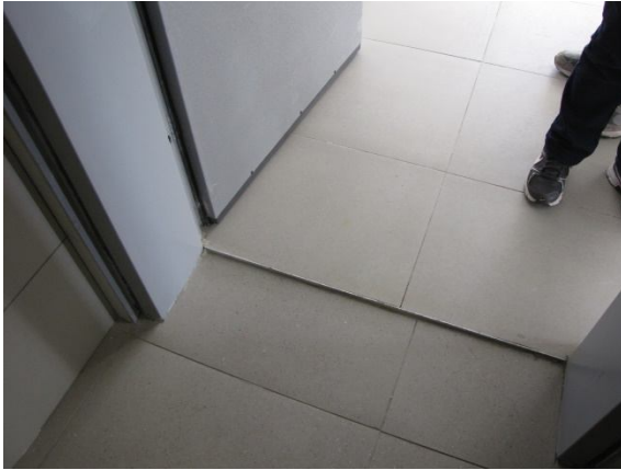
9.2. סרגל מתכת דלת אמבטיה בולט. נדרש : הנמכת הסרגל.
