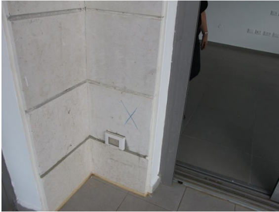
11.2. אבן סומנה להחלפה ע"י הקבלן ולא הוחלפה. נדרש : החלפת אריח החיפוי.
