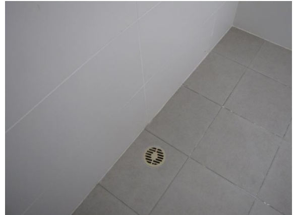
5.3. שימוש ברשתות ניקוז וקופסאות בקורת מפלסטיק כאשר מקובל היום שימוש ברשתות ניקוז וקופסאות בקורת מפליז או נירוסטה. נדרש: החלפה לפיז או נירוסטה.
