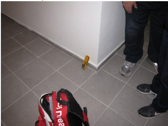
2.4. מחסן הדירה מס' 97, מד רטיבות מראה רטיבות כלואה ברצפה ורטיבות בתחתית קיר בפינה ליד הדלת. נדרש : איתור ואיטום מקור הרטיבות.
