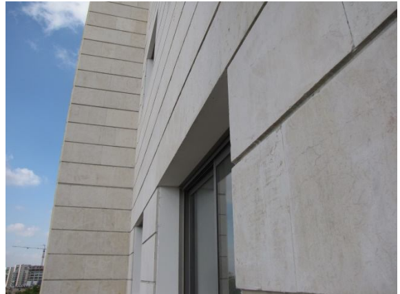
8.3. חסר אף מים בחלון מטבת, מי גשם מהקיר יזחל על תקרת החלון ויגרום לכתמים ורטיבות. נדרש: ביצוע אף מים.
