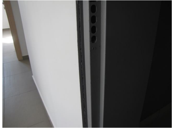
8.1. דלת ראשית, צבע חריץ משקוף לא אסטטי. נדרש: תיקון צבע סביב משקוף דלת ראשית.
