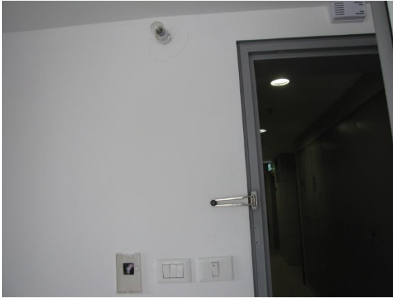
8.2. סביב דלת ראשית סומן ע"י הקבלן לתיקון צבע ולא תוקן. נדרש: תיקון שפכטל וצבע.
